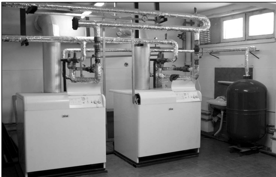
Una dintre cele 10 centrale termice
